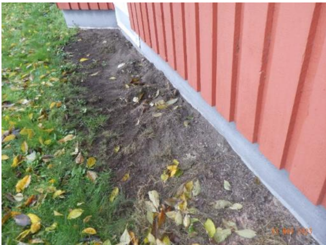
Bild 13. Synlig sockel på norra sidan. Gräsmatta mot sockel binder mera fukt mot byggnaden än ett dränerande gruslager.
