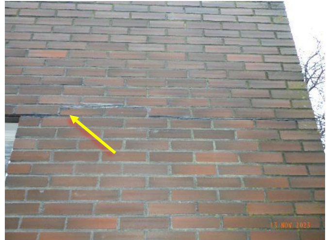
Bild 20. Sprickor observerades ställvis i tegelmuren.
