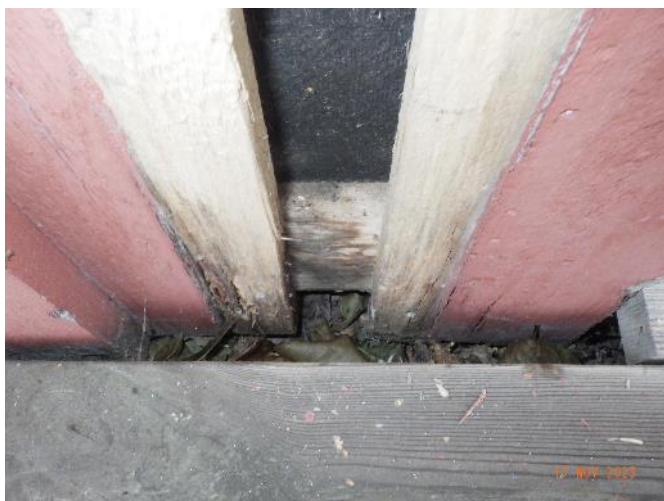
Bild 25. Nedre delen av fasaden rötskadad vid kontrollhålsplatsen.
