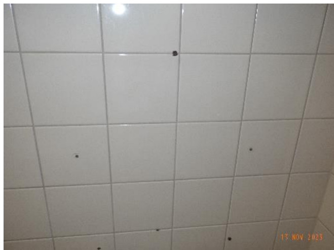
Bild 38. I badrummen finns otäta borrhål. Risk för att fukt och vatten tränger under tätskiktet via hålen.
