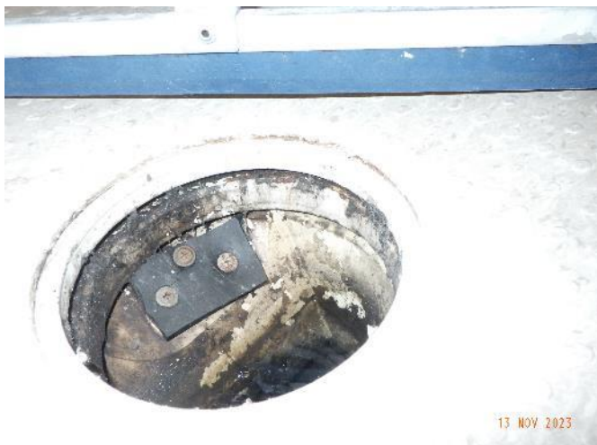
Bild 41. Golvbrunnen i lägenhet 10. Man skruvat fast en gummi bit på rengörings hålet. Risk för att man skadat bakomliggande delar av brunne då man skruvat i den.
