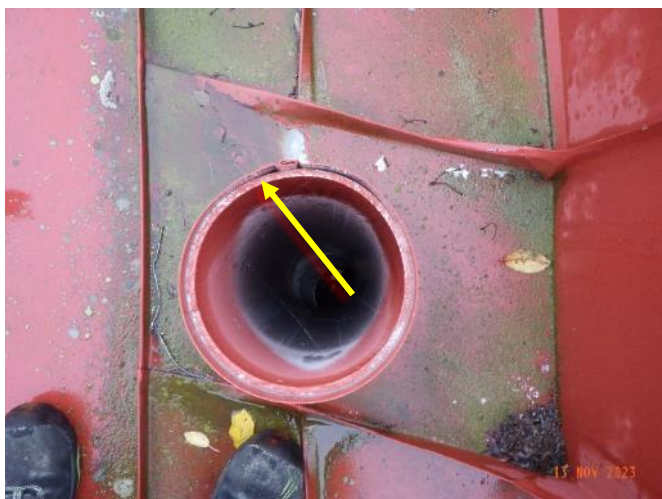
Bild 5. Tätningsmassa saknas mellan plaströr och plåt kon. Risk för att vatten tränger sig mellan plaströret och plåten.
