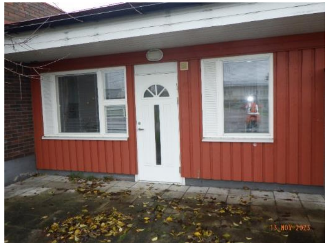
Bild 18. Man kan se att ytterdörren går ner i sockeln på de västra delarna av byggnaden. Vilket tyder på att man har en blindsockel konstruktion på denna del av byggnaden. Blindsockel är en riskkonstruktion vad gäller fukt- och mögelskador.
