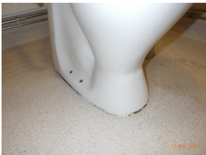
Bild 39. I lägenhet 9 observerades vatten ha samlat sig kring toaletten. Då toaletten även är skruvad fast i golvet kan det finnas risk för att vatten tränger sig in under plastmattan. Problem med vattensamlingar på golv observerades i merparten av badrummen i den berörda delen.
