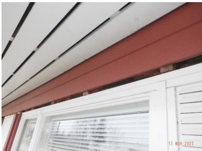
Bild 23. Vid lägenhet öster om burspråket saknas foderlist ovanför fönstret.
