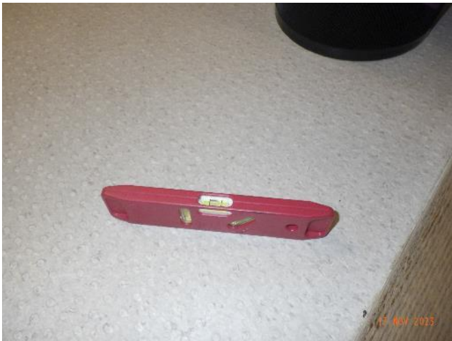
Bild 35. Bakfall mot tröskel i lägenhet 6 badrum. Samma problematik observerades i nästa alla badrum.
