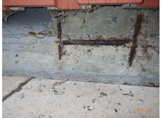
Bild 16. På södra sidan observerades armeringen vara synlig framme. Då korrosion sker på armeringen expanderar järnet vilket i sin tur leder till att betongen spricker eller går sönder. Vid detta område ser även armeringen ut att vara väldigt nära ytan på betongen.
