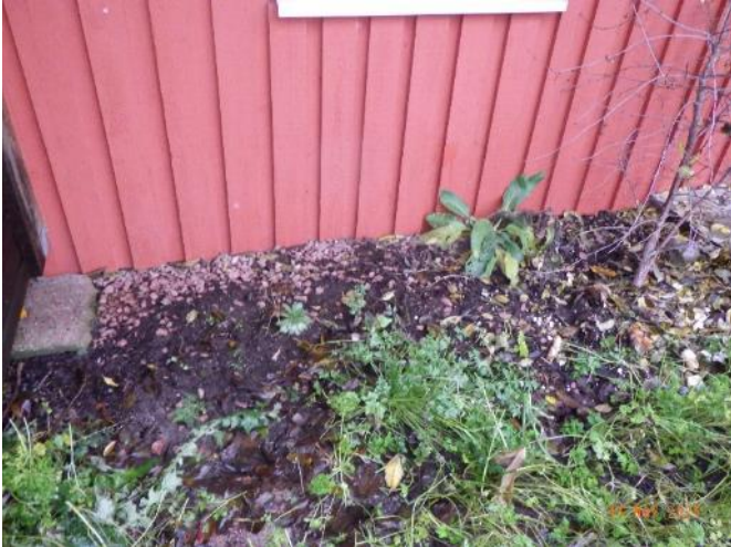
Bild 15. På de östra delarna av byggnaden är merparten av sockeln i eller helt under marknivå. Ökar risken för fuktskador i ytterväggarnas nedre del.
