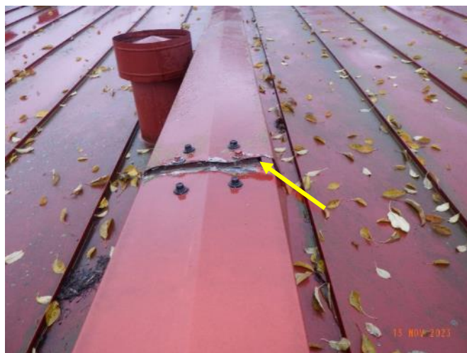
Bild 6. Kantplåt på tegelmur observerades ställvis vara otät monterad.
