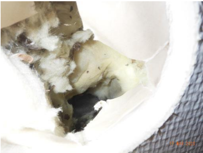
Bild 29. Kontrollhålet som öppnades inifrån i ytterväggen med tegelfasad i lägenhet 6. Spår av möss observerades inuti väggen.
