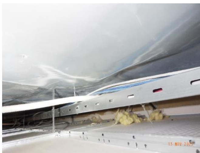
Bild 10. En ångspärr av plast observerades vara monterad under värmeisoleringen då man tittade in under takskivor i korridoren.
