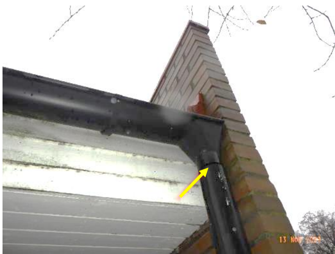
Bild 9. Vid nordvästra hörnet observerades anslutningen av stupröret till hängränna ej att vara på sin plats.
