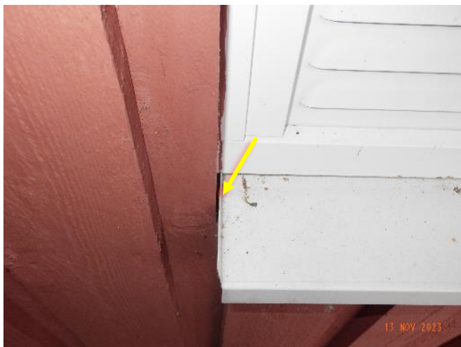
Bild 32. Fönsterbleck vid träfasaden otät monterade.
