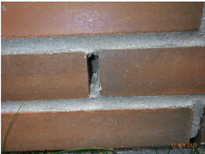
Bild 21. Stötfog som man lämnat öppen för luftning bakom tegelmuren. Inre sidan av fogen är dock igensatt vilket gör att ingen luftning är möjlig.
