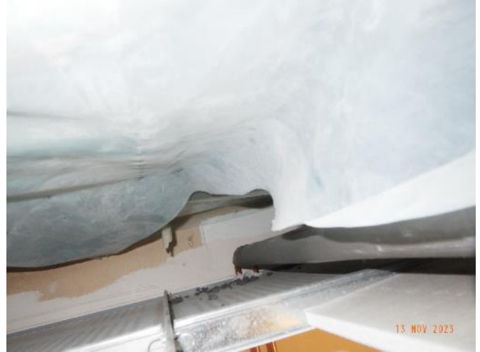
Bild 12. Överlapp av i plasten konstaterades ej har tejpats med för ändamålet menat tejp, ångspärren otät.
