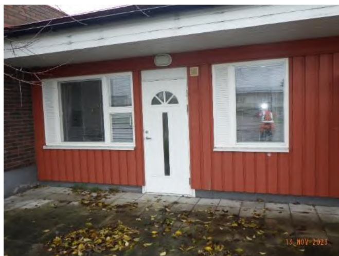
Bild 18. Man kan se att ytterdörren går ner i sockeln på de västra delarna av byggnaden. Vilket tyder på att man har en blindsockel konstruktion på denna del av byggnaden. Blindsockel är en riskkonstruktion vad gäller fukt- och mögelskador.
