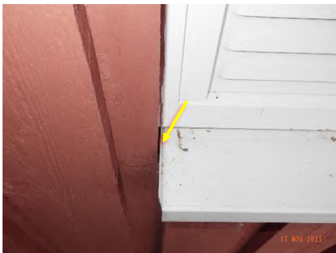
Bild 32. Fönsterbleck vid träfasaden otät monterade.
