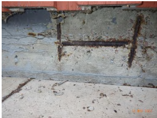
Bild 16. På södra sidan observerades armeringen vara synlig framme. Då korrosion sker på armeringen expanderar järnet vilket i sin tur leder till att betongen spricker eller går sönder. Vid detta område ser även armeringen ut att vara väldigt nära ytan på betongen.
