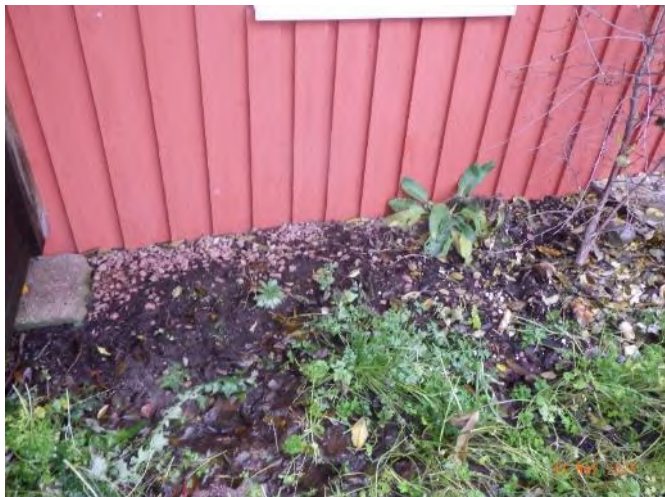
Bild 15. På de östra delarna av byggnaden är merparten av sockeln i eller helt under marknivå. Ökar risken för fuktskador i ytterväggarnas nedre del.
