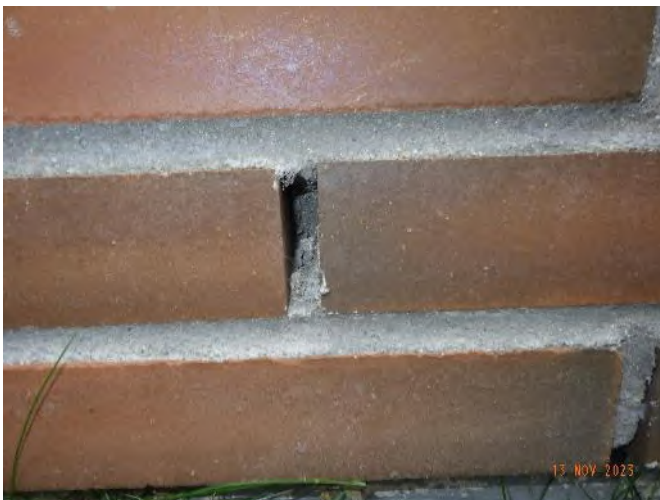
Bild 21. Stötfog som man lämnat öppen för luftning bakom tegelmuren. Inre sidan av fogen är dock igensatt vilket gör att ingen luftning är möjlig.
