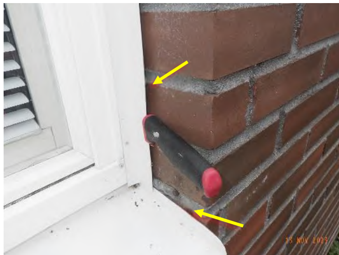
Bild 31. Fönsterbleck samt anslutning mellan fönsterkarm och vägg otät.
