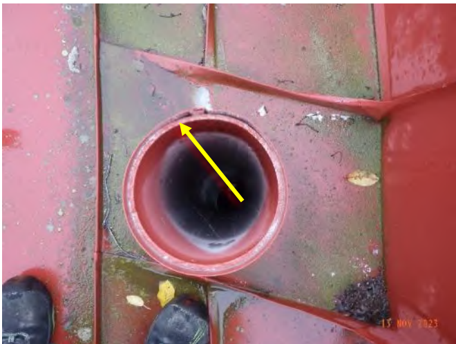
Bild 5. Tätningsmassa saknas mellan plaströr och plåt kon. Risk för att vatten tränger sig mellan plaströret och plåten.
