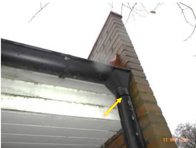
Bild 9. Vid nordvästra hörnet observerades anslutningen av stupröret till hängränna ej att vara på sin plats.
