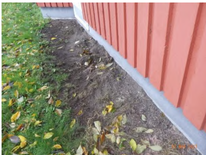
Bild 13. Synlig sockel på norra sidan. Gräsmatta mot sockel binder mera fukt mot byggnaden än ett dränerande gruslager.
