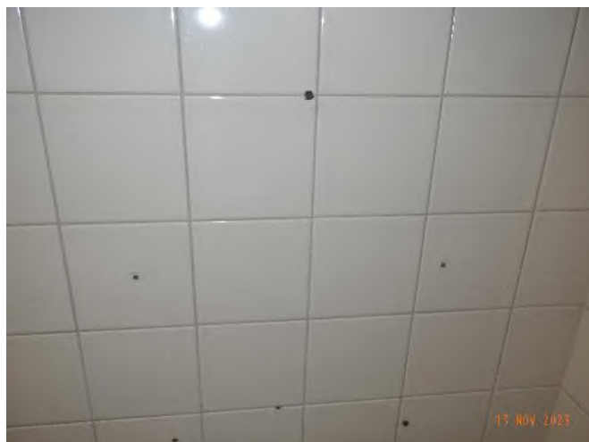
Bild 38. I badrummen finns otäta borrhål. Risk för att fukt och vatten tränger under tätskiktet via hålen.
