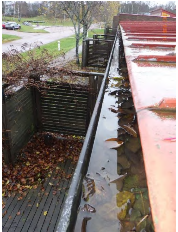
Bild 8. Hängrännor löv- och vattenfyllda.
