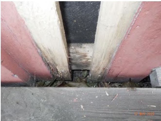
Bild 25. Nedre delen av fasaden rötskadad vid kontrollhålsplatsen.
