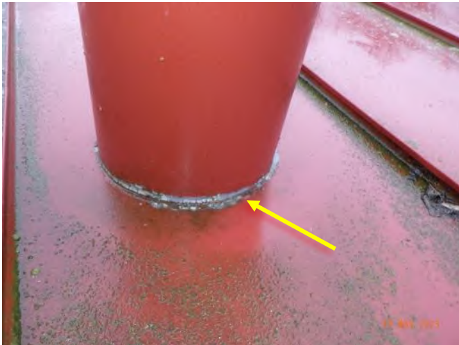
Bild 7. Kring de runda genomföringarna har färgen flagnat. Ökar risken för att plåten rostar och skapar otätheter vid genomföringen.
