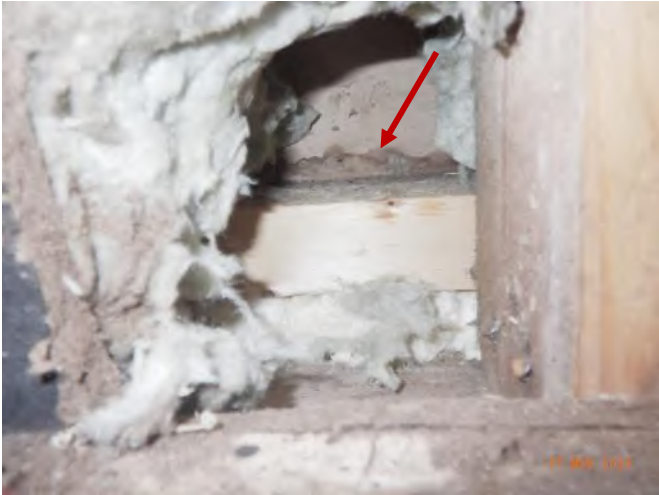
Bild 27. Missfärgningar som tyder på fuktskador observerades inuti väggkonstruktionen vid kontrollhålet.
