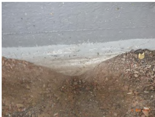
Bild 14. Inget fuktskydd ser ut att finnas på sockel under mark.
