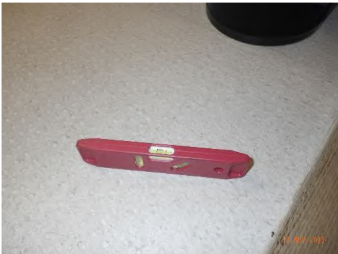
Bild 35. Bakfall mot tröskel i lägenhet 6 badrum. Samma problematik observerades i nästa alla badrum.
