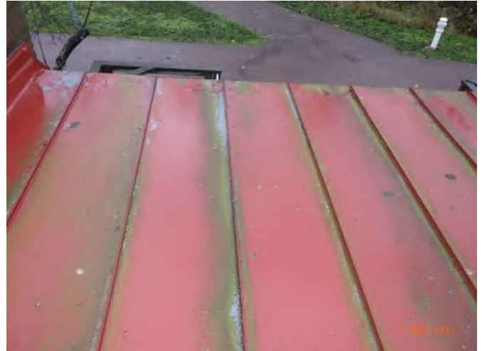
Bild 4. Algpåväxt samt flagnad färg observerades ställvis på plåten.
