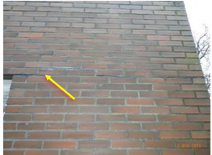
Bild 20. Sprickor observerades ställvis i tegelmuren.
