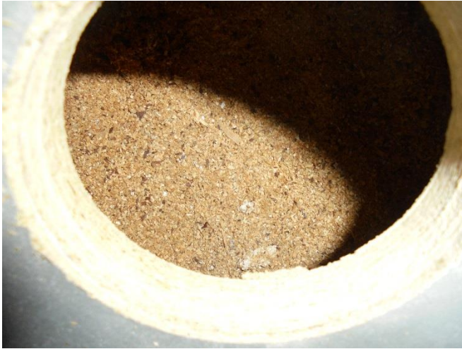
Bild 3. Prov MP9 togs av spån. Provet innehöll fuktskadeindikatorarter.
