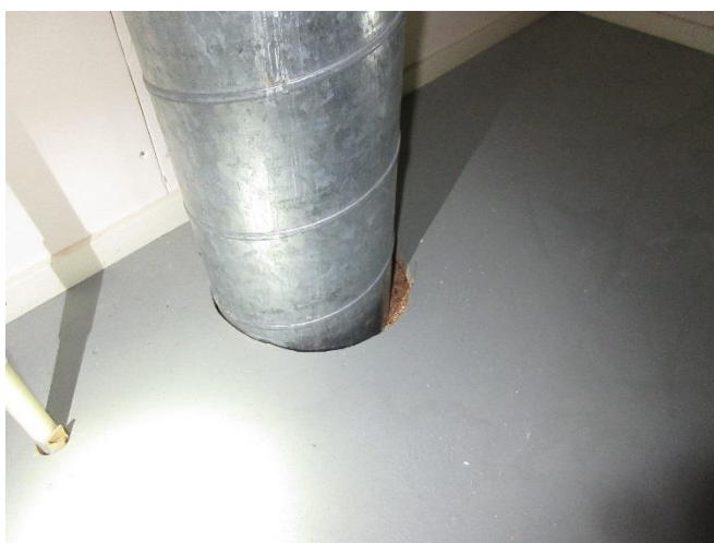
Bild 21. I mellanbjälklaget har tidigare konstaterats mikrobiella skador, och åtminstone i ventilationsrummet finns gammal isolering kvar i bjälklaget.
