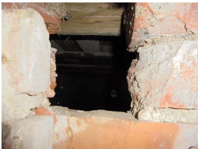
Bild 8. Golvtyp1. Golvbjälklag, kryputrymme under tambur utan tillträde, fotograferat genom glugg i källarvägg.
