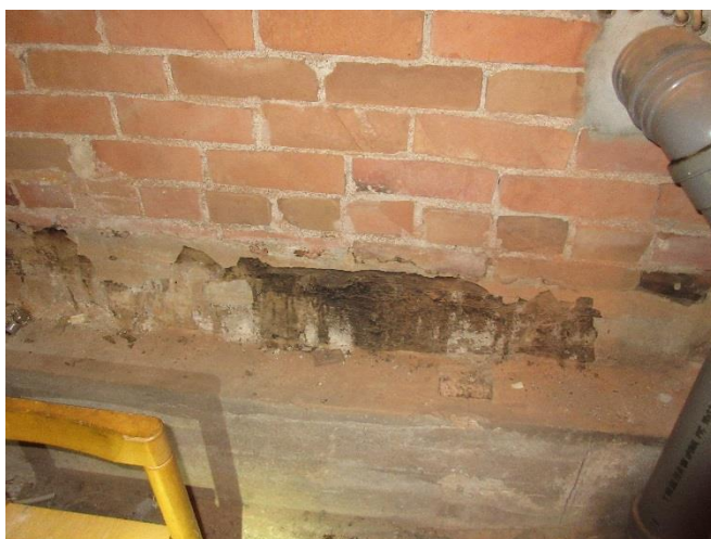
Bild 14. En stenkolstjära innehållande PAH-föreningar observerades i källaren.
