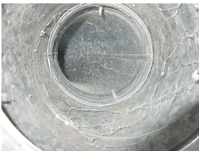
Bild 19. Så småningom är ventilationssystemet i behov av rengöring.
