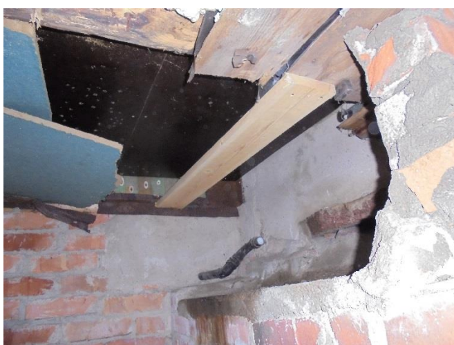
Bild 16. En del av golvet oisolerade del har vattenfast fanerskiva som botten, på skivornas undersida observerades något som kan vara mikropåväxt. Påväxten har högst sannolikt orsakats av att kondensdroppar bildats på skivans glatta undersida och damm eller andra orenheter har gett näring åt påväxten.
