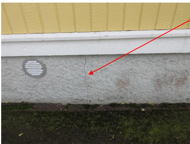
Bild 3. Någon enstaka spricka observerades i stenfoten.
