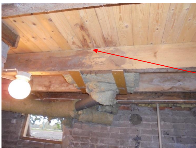
Bild 11. Golvtyp4. Man kunde konstatera att bjälklaget saknar värmeisolering i husets norra del. I kryputrymmet finns ett värmeelement.
