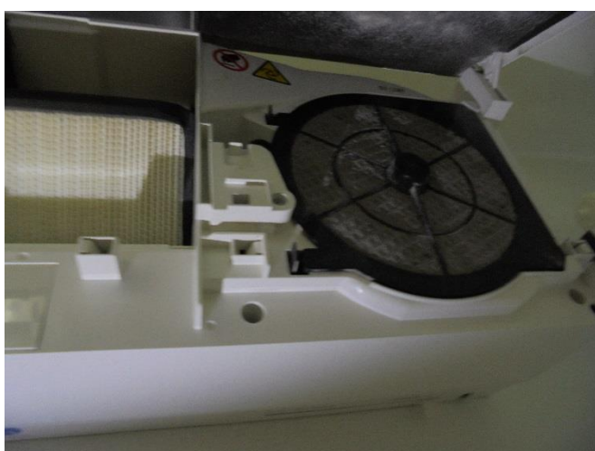
Bild 18 Frånluftssidan på ventilationsmaskinen är i behov av underhåll.
