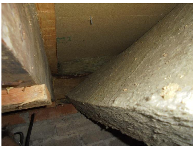
Bild 14. Ställvis observerades isolering, dock är den ej sakenligt installerad fungerar ej som värmeisolering för golv.
