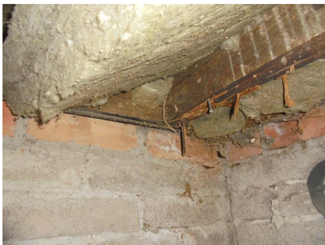
Bild 15. Kryptutrymme mot norr. Synliga rötskador observerades ställvis. Då det i trämaterial finns synliga rötskador finns det alltid mikrob- och bakterietillväxt på materialet.
