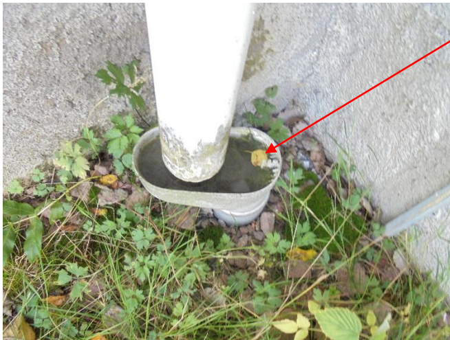
Bild 4. Regnvattensystemets delar bör rengöras regelbundet.
