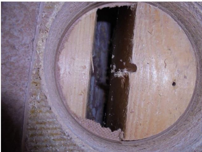
Bild 5. Bärande stock observerades i kontrollhål i golv. Materialprov MP10 togs av regel ovanför. Ingen aktiv mikroväxt konstaterades.
