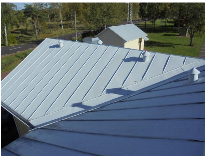
Bild 5. Vattentaket är still största del helt. Några enstaka rostfläckar konstaterades. Tillgång till mellantaket fanns ej.
