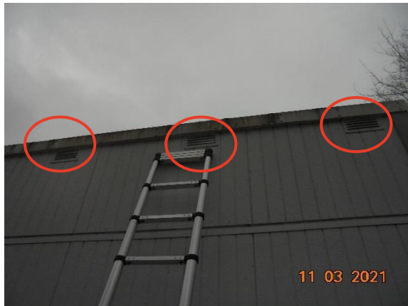
Bild 1. Luftningshål för övre bjälklag observerades.
