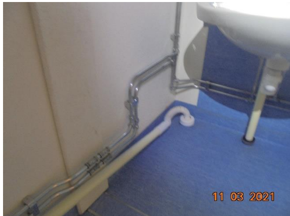
Bild 14. I allmänhet är bruksvattenrör ytmonterade, kromade kopparrör.
