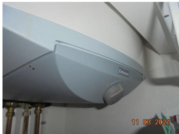
Bild 36. Elektrisk varmvattenberedare i förråd.
