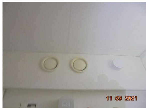
Bild 17. Skötrum har endast frånluft, överluftsdon finns ovanför dörren. Tilluftskanalen är pluggad.
