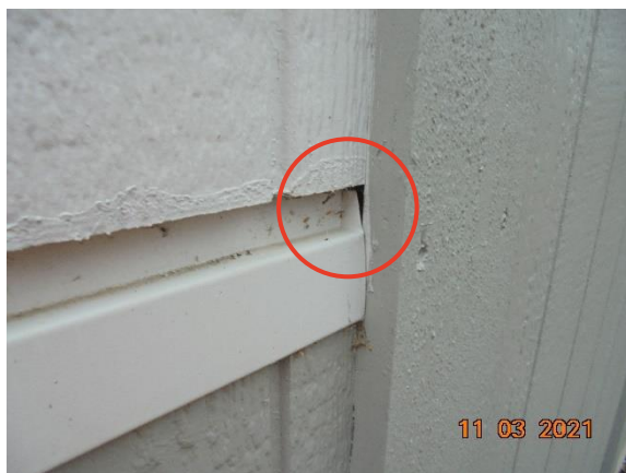
Bild 11. Vi rekommenderar att man håller dylika otätheter tätade så att inte drivande nederbörd tränger in bakom fasadmaterial och orsakar fuktskador på sikt.
