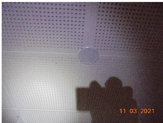
Bild 32. I mindre lekrummet/ vilorummet har man plockat ner brandvarnare.
