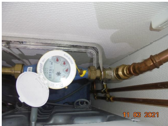
Bild 35. Vattenmätare bakom tvättmaskin i förråd. Ansluten med kopparrör.
