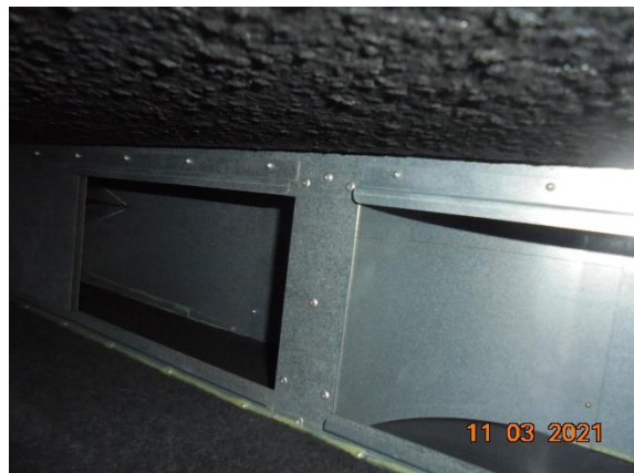
Bild 40. Åtkomliga kanaler från aggregat granskades vid granskningstillfället och såg rena ut.
