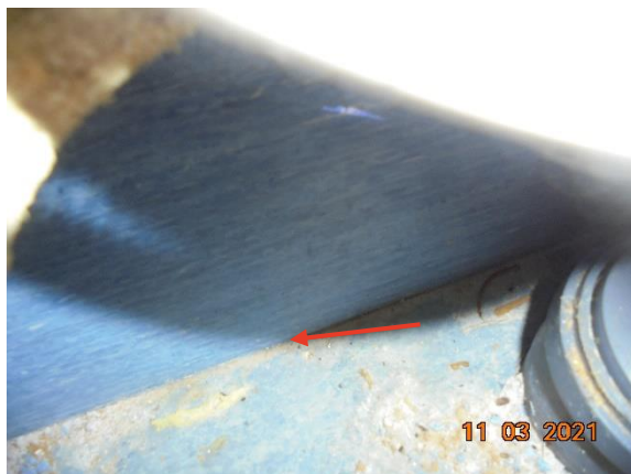
Bild 30. Under skåpinredningar finns plastmatta på golv och vägg. Tätheten mellan vägg och golv i vinkeln svår att bedöma okulärt endast genom hål i skåpbotten.
