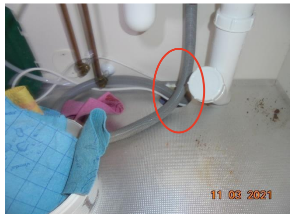
Bild 31. Skåpbottens genomföringar bör tätas för att botten ska fylla sin fuktskyddande och läckageindikerande funktion, det vill säga att eventuell läckagevatten som rinner ner i skåp ska rinna ut i framkant för att upptäckas i god tid.
