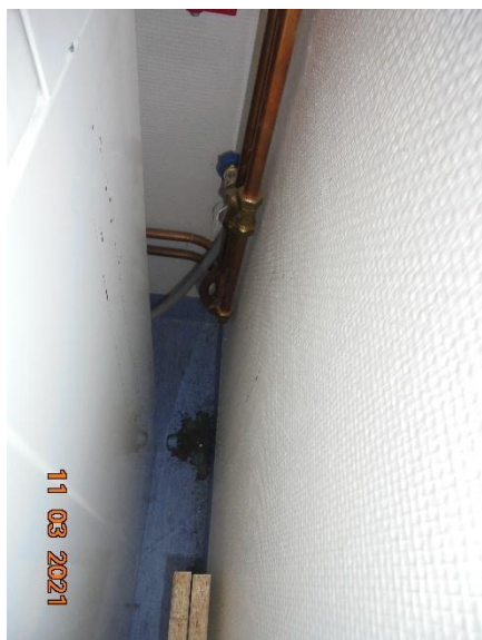
Bild 27. Fläck på golv bakom tvättmaskin observerades.
