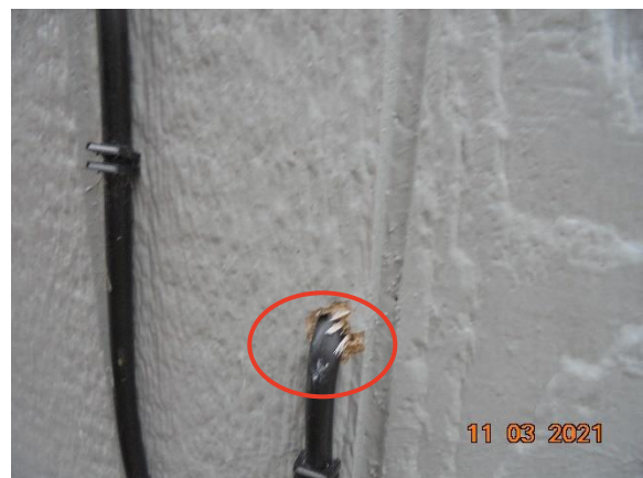
Bild 12. Vi rekommenderar att man håller dylika otätheter tätade så att inte drivande nederbörd tränger in bakom fasadmaterial och orsakar fuktskador på sikt.
