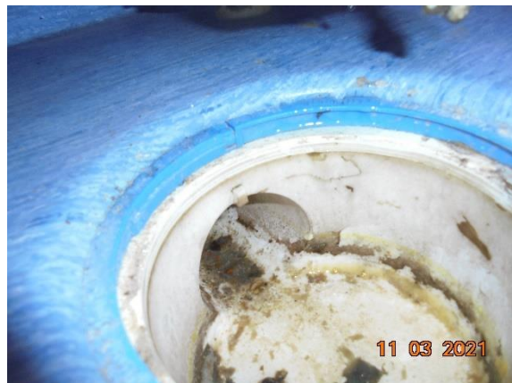
Bild 26. I övrigt ser golvbrunn okulärt sett ut att vara sakenligt monterad till golvets tättskikt. Ligger vatten på botten i golvbrunn som kan vara indikator på svag lutning i utloppet.
