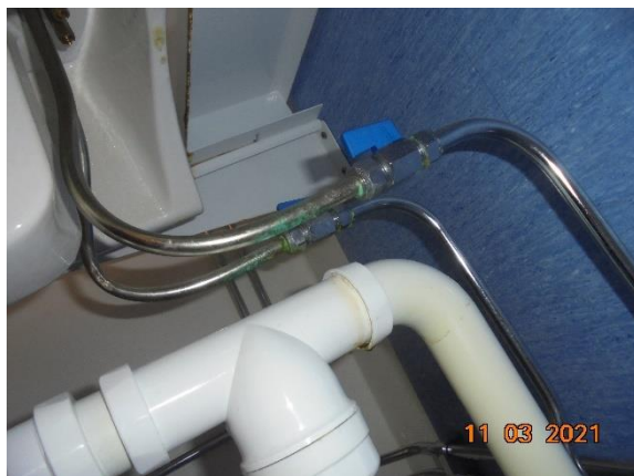
Bild 16. Begynnande korrosion på bruksvattenrör kunde observeras.
