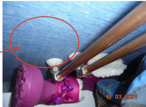
Bild 20. Då man granskade skåp under tvättställ i tambur såg man rinnmärken längs vägg, vi rekommenderar att man lägger en tätande mjukfog mellan bänksplåt och vägg för att undvika att vattenstänk rinner in bakom skåp, även om ytor är försedda med täta skikt.
