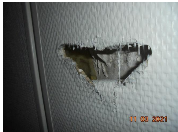
Bild 33. I mindre lekrummet/ vilorummet har dörrhandtaget gjort hål i mellanväggen, rekommenderas att repareras och förses med skydd.
