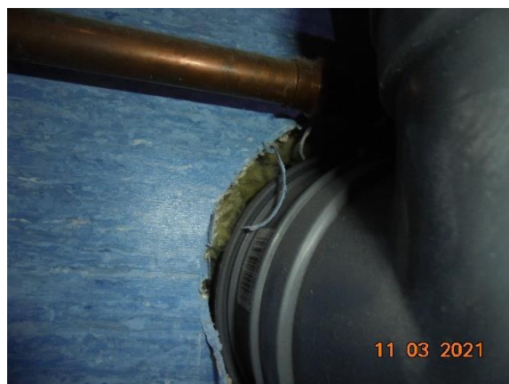
Bild 38. Genomföring för avlopp i vägg mellan förråd och WC otät.
