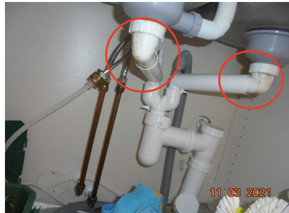
Bild 29. Rinnmärken på rördelar, avloppsrör under diskho observerades men inget aktivt läckage noterades.
