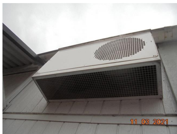
Bild 42. Avluft och uteluftintag finns bredvid ytterdörren. Avskiljs sakenligt med plåtlåda.
