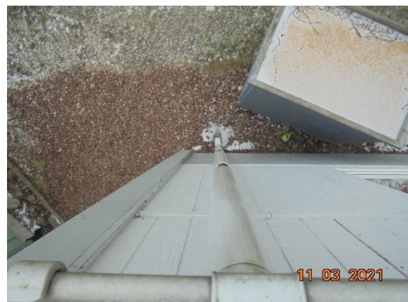
Bild 6. Regnvatten leds ut direkt på marken av krossgrus.
