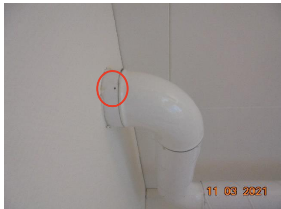
Bild 44. Fästdon saknas i skarv på ventilationskanal.
