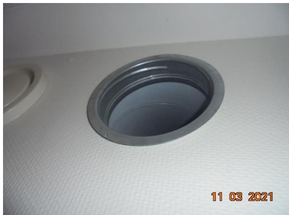
Bild 43. Frånluftskanalens anslutningskrans ej infäst i väggen i arbetsrum.
