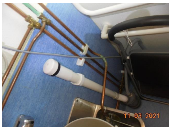
Bild 37. Avloppsluftning sker med vacuumventil i förråd.
